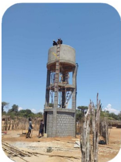
Château d'eau 10m3 alimenté par une pompe solaire sans batterie à Ankevo,
