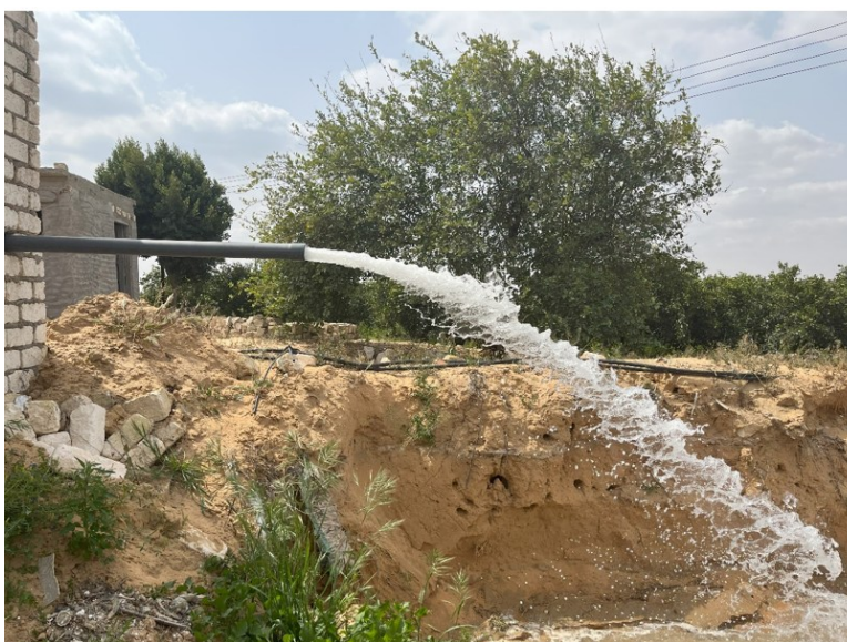
Pompe solaire et maraichage (Noubarayia, Egypte)
