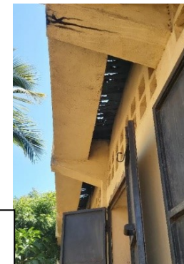
Vue sous les avants toits ; on aperçoit les tôles oxydées et trouées.
