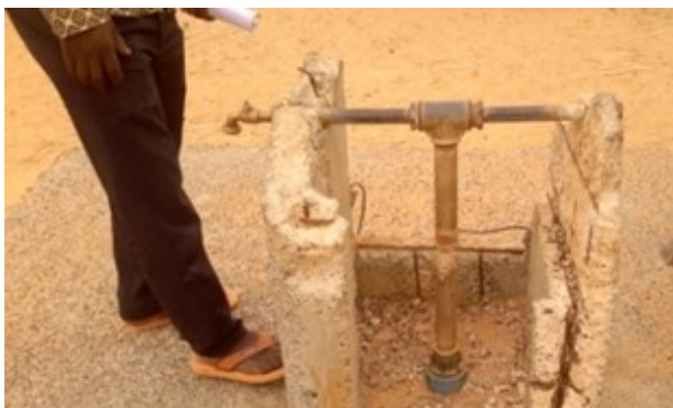
Une des bornes-fontaines existantes
